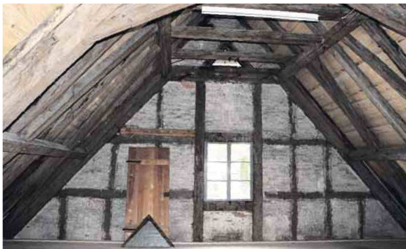
Der grosse Estrich ist zwar nicht isoliert, hat aber ein neues Unterdach erhalten.
