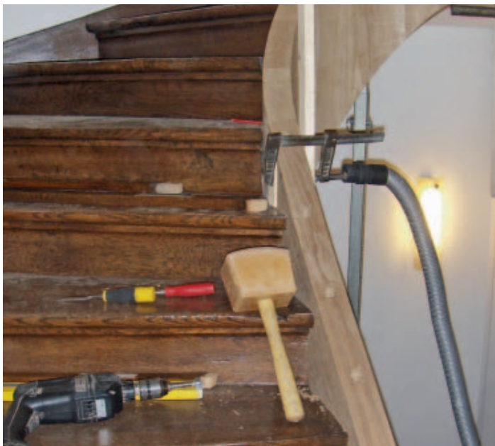
Der betroffene Bereich musste in der Folge komplett erneuert werden.
