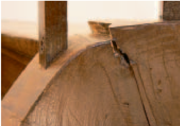
Eine vorangegangene Sanierung des Luzerner Regierungsgebäudes führte Jahre später zum Bruch dieser Eichenwange.
