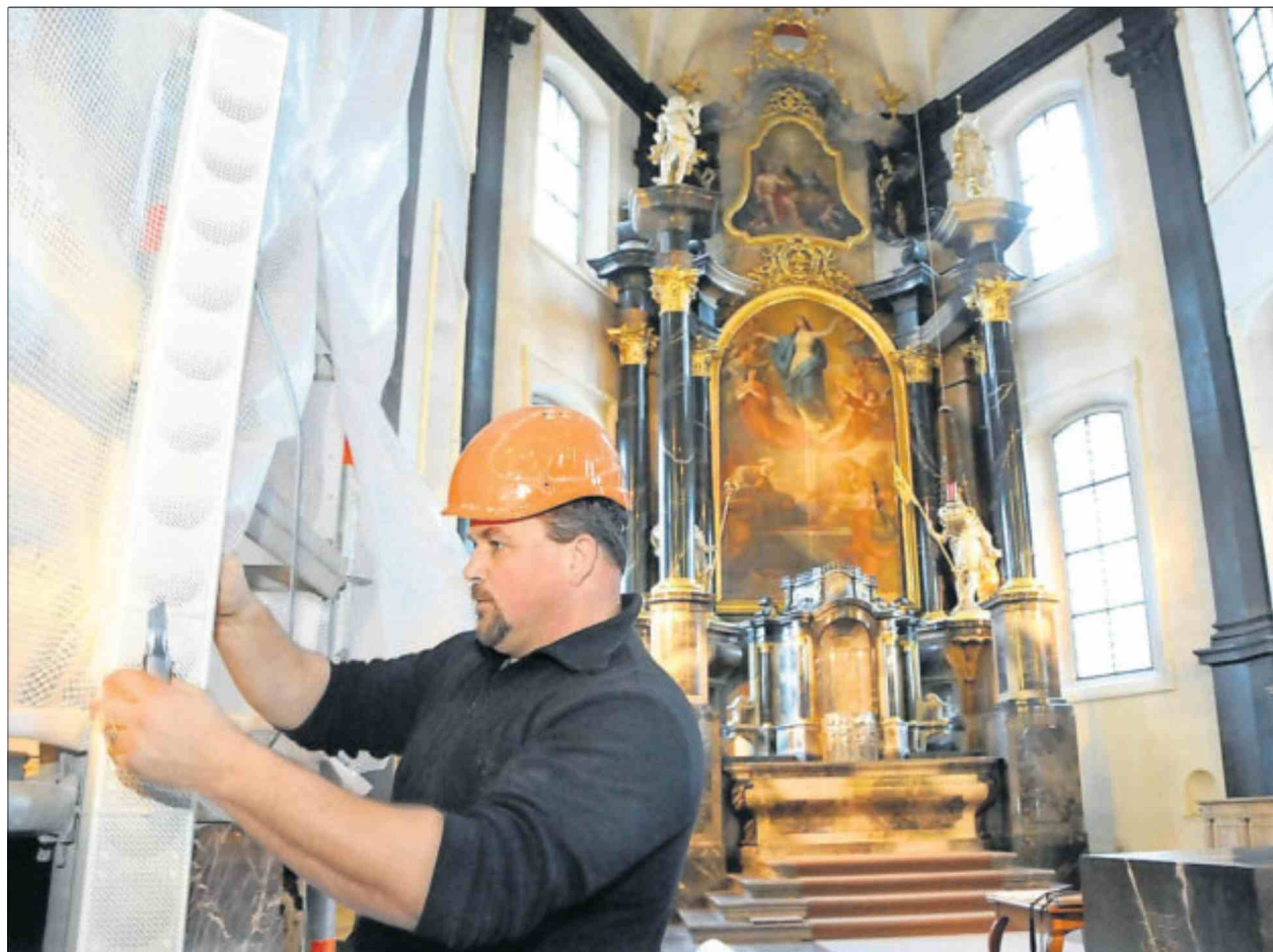
Innenrenovation in der Pfarrkirche Sachseln: Peter Herger von der Lawil Gerüste AG an der Arbeit.
