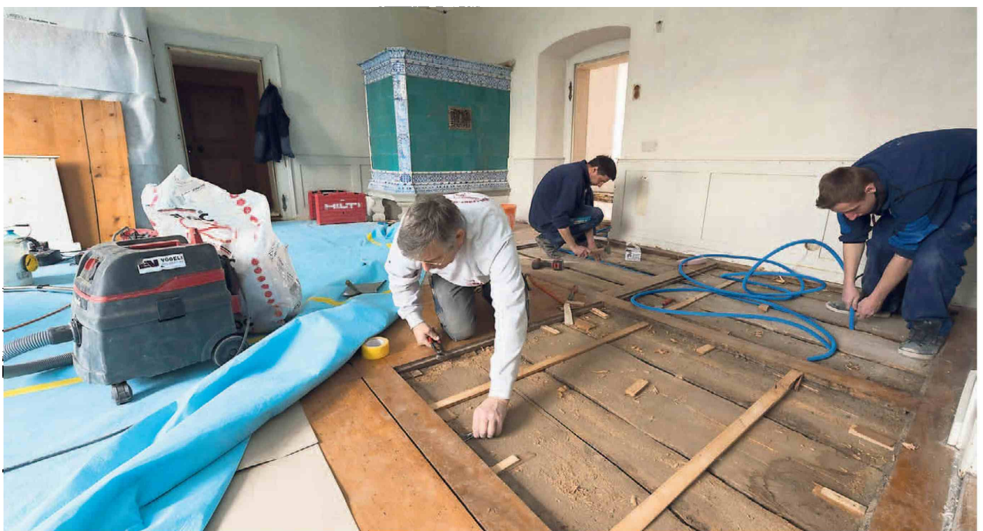
Die Handwerker müssen geübt sein, um die Leitungen unter den alten Holzböden in der Propstei verlegen zu können.
