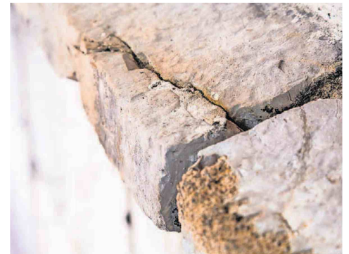
Solche Risse im Jura-Kalkstein der Schönenwerder Kirche werden saniert.
